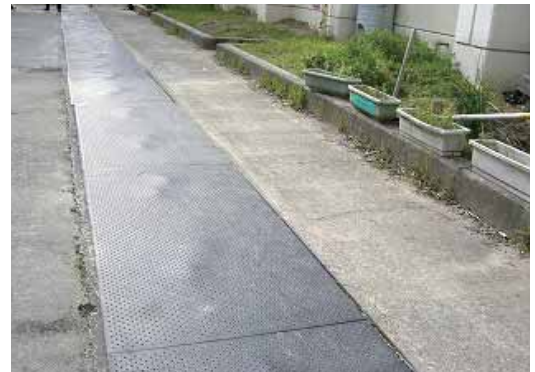
小学校 排水溝カバーとして
